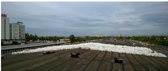
Рис. 2. Общий вид нагруженного фрагмента покрытия
