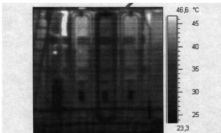
Рисунок 42 - Термограмма поверхности бака трансформатора типа ОДГ-35000/150 со стороны ВН (стрелкой указан перекрытый радиатор)
