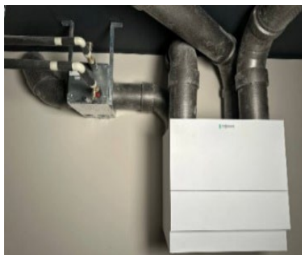
Рис. 3. Фото обвязки приточно-вытяжной вентиляционной установки с рекуперацией тепла и системой пассивного охлаждения через геотермальный контур
