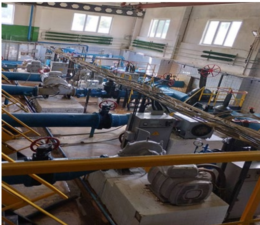
Рис. Станция обеззараживания воды
