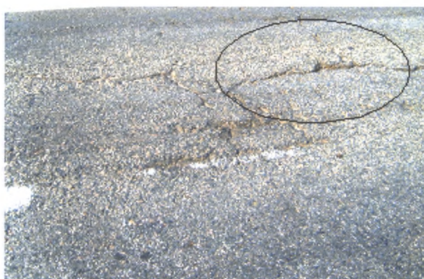
в) Трещины шириной раскрытия более 10 мм
