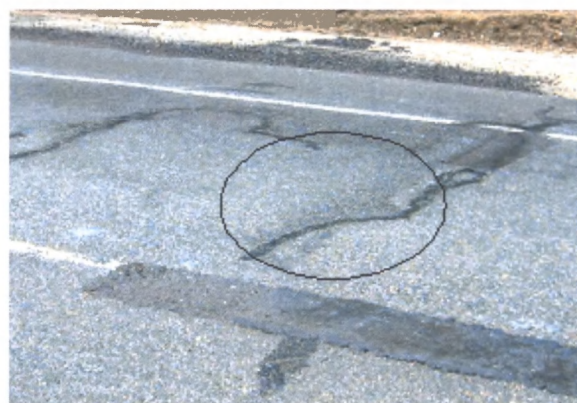
г) Трещины залитые битумной эмульсией
