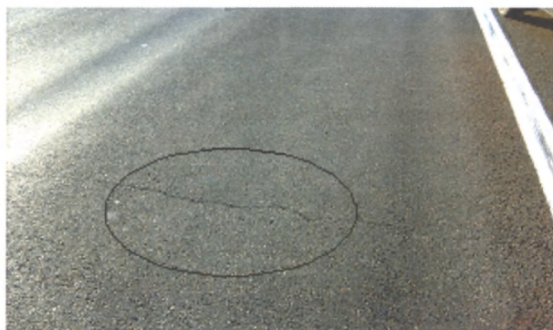
а) Нитевидные трещины
