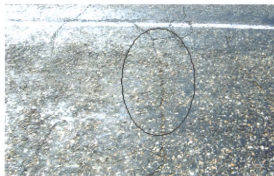
б) Трещины шириной раскрытия до 10 мм
