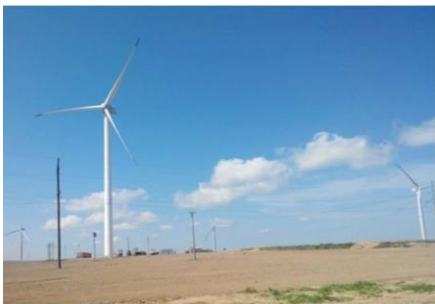
Рисунок 4. Новогрудская ветроэлектрическая станция (парк) суммарной мощностью 9 МВт
