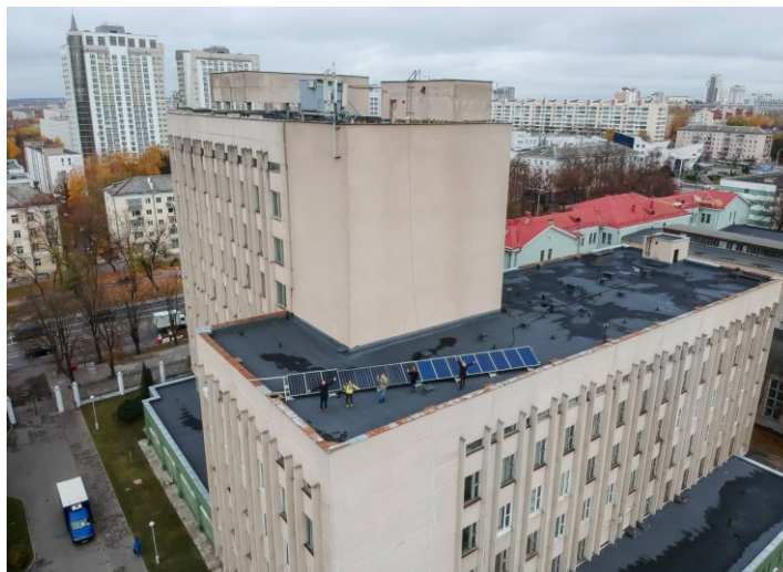
Рисунок 2 – «Солнечные батареи на территории БНТУ»
