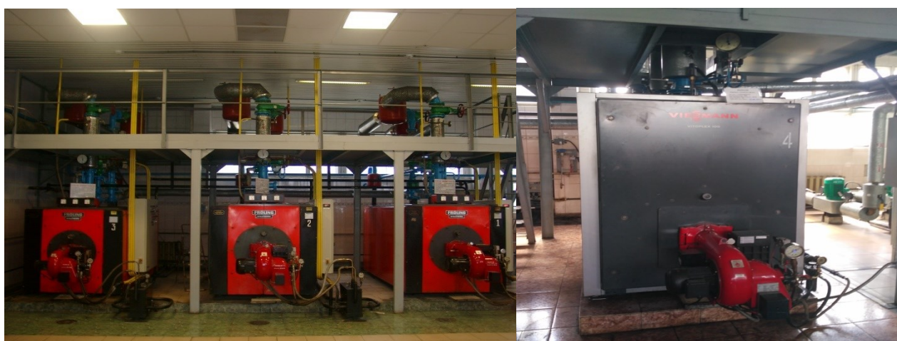
Рисунок 1 - Котлы, установленные на котельной вместе с горелками
