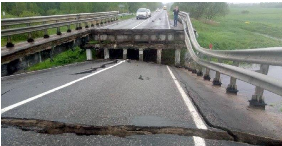
Рисунок 1 – Обрушение моста в районе деревни Новосёлки
