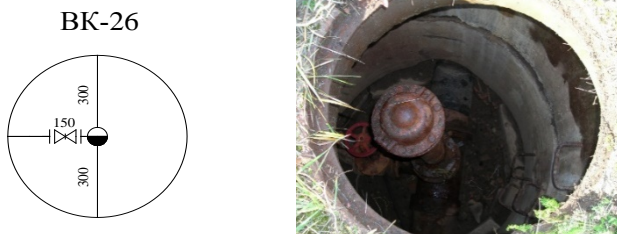
Рис. 6. Водопроводный колодец ВК-26
