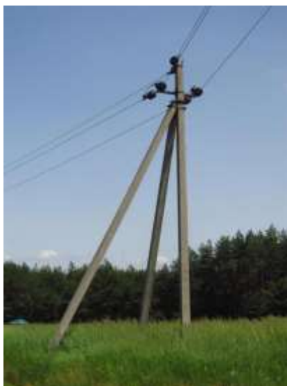
Рисунок 2. Железобетонная опора ВЛ-10 кВ
