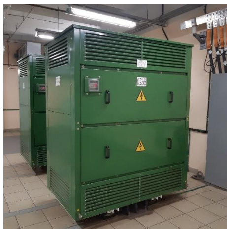
Рисунок 3 – Трансформатор освещения ТСЗГЛ-250/10
