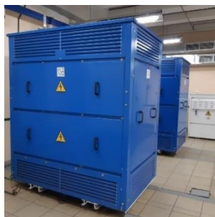
Рисунок 2 – Силовой трансформатор ТСЗГЛ-630/10-У3
