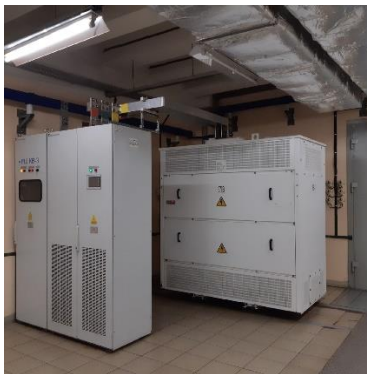
Рисунок 1 – Тяговый трансформатор ТСПЗГЛ-1600/10–У3
