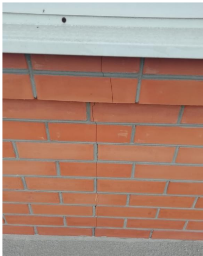
Рис. 3 – Формирование трещин в новых зданиях
