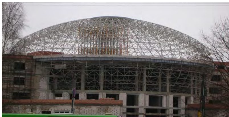
Рисунок 38 – Общий вид структурного купола здания Национального олимпийского комитета Республики Беларусь в Минске
