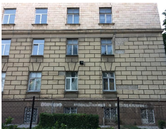
Рис. 2 – Развитие трещин в учебном корпусе автодорожного института
