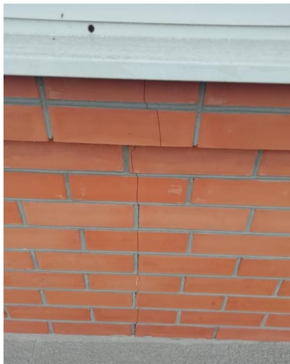
Рис. 3 – Формирование трещин в новых зданиях
