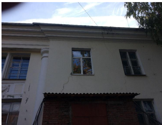
Рис. 1 – Трещины в здании драматического театра
