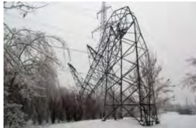
Рис. 2. Разрушенная опора ВЛ под воздействием гололёда.
