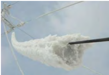
Рис. 1. Образовавшийся гололёд на проводах ВЛ
