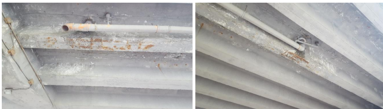
Рисунок 1 – Водоотвод, коррозия арматуры
