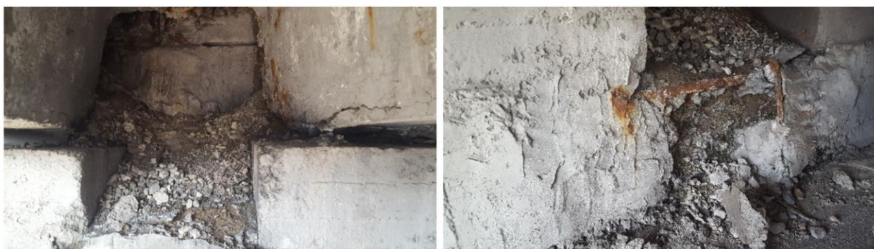
Рисунок 3 – Разрушение узла опирания балки
