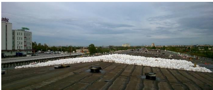
Рис. 2. Общий вид нагруженного фрагмента покрытия
