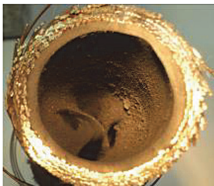
Рис. 6. Разрушения на внутренней камере
