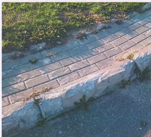
Рисунок 2 – Бордюр дорожный с механическими повреждениями
