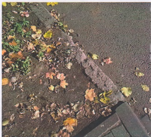
Рисунок 3 – Бордюр дорожный с коррозионными повреждениями
