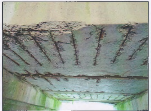
Рисунок 5 – Оголенная арматура в нижней части пролетного строения
