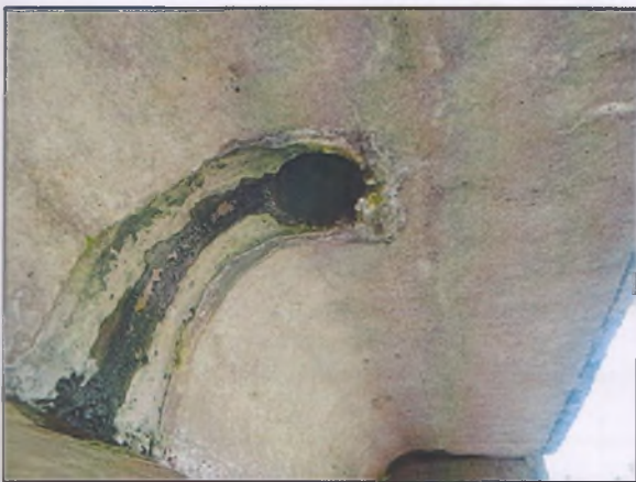
Рисунок 7 – Отсутствующая водоотводная трубка
