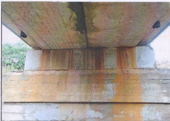
Рисунок 6 – Фильтрация и подтеки на устое моста и между секциями пролетного строения
