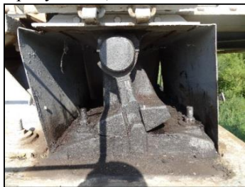
Рисунок 2 – Угон опорной части, выработка опорных зубьев
