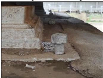
Рисунок 1 – Ослаблен болт крепления опорной части
