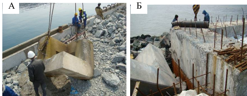
Рис. 2. Характерный вид разрушения бетона в зоне переменного уровня после первого зимнего сезона: А – берегоукрепление из гексабитов в порту Козьмино (г.Находка, Приморский край, 2008 г); Б – причальная стенка в порту Углегорск (о. Сахалин, 2010 г).
