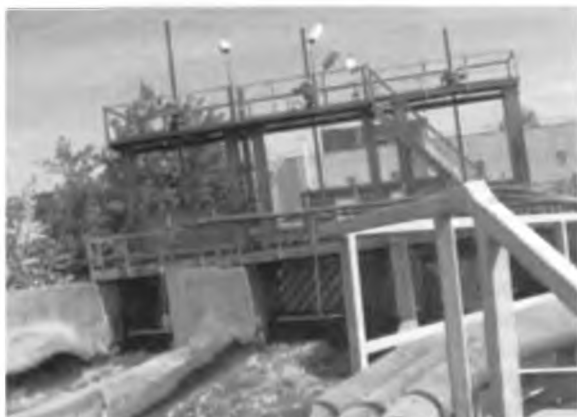
Рис. 12. Вид установки введения реагента в поток сточных вод перед первичными отстойниками на очистных сооружениях, г. Санкт-Петербур
