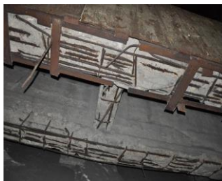
Коррозия рабочей арматуры рам эстакады
