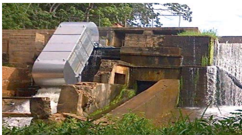
Рисунок 7 – Гидроагрегат мощностью 12 кВт, расходом 400л/с, напор 3,5 м
