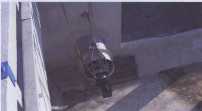
Рис. 5. Вид рециркуляционного насоса, смонтированного в нитрификаторе
