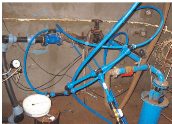
Рисунок 4б – Устье скважины с обвязкой при закачке воды в четыре циркуляционные трубки.
