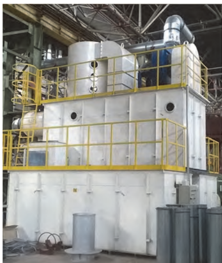
Рис. 7. АБХУ, эксплуатируемая на ООО «Техпромлит»
