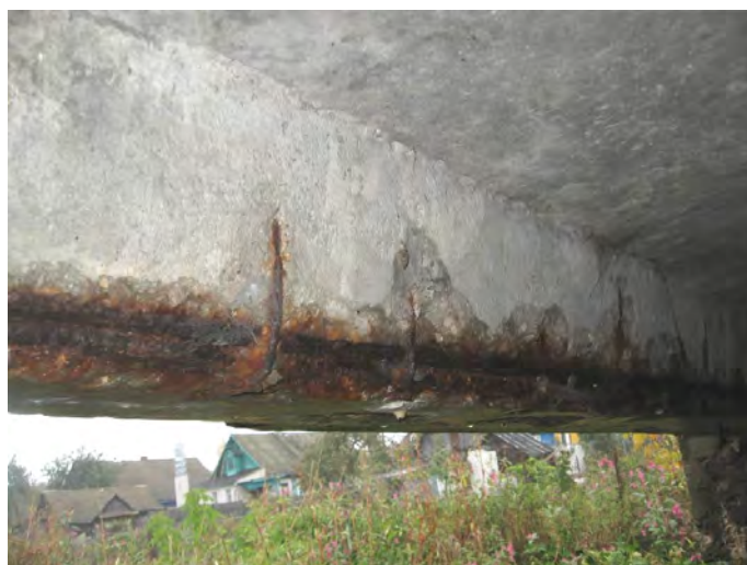
Рис. 2. Мост через р. Дунайчик в г. Смолевичи: размораживание бетона плиты П1 в пролете № 1, оголение и коррозия арматуры
