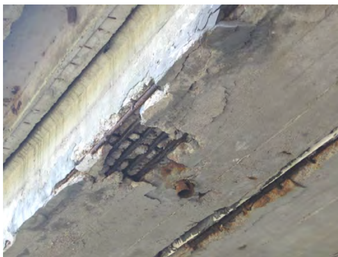
Рис. 1. Мост через р. Рита на а/д Р-17 Брест – гр. Украины: разрушение бетона крайних плит в пролете № 4, коррозия стержней рабочей арматуры
