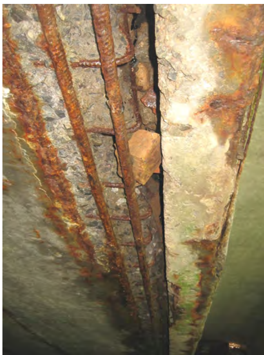
Рис. 3. Мост через ручей на а/д Р-62 Чашники – Бобр – Бобруйск: размораживание бетона плиты, коррозия арматуры, выключение из работы крайнего стержня в результате потери сцепления с бетоном
