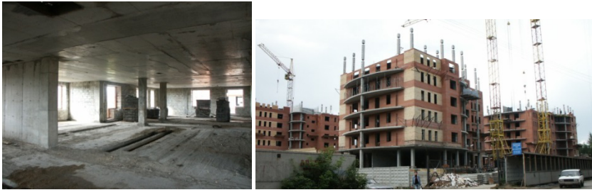
Рис. 7. Многоэтажный жилой дом в стадии строительства. Примеры. а) общий вид здания, б) интерьер, гладкие потолки позволяют устанавливать перегородки практически в любом месте перекрытия
