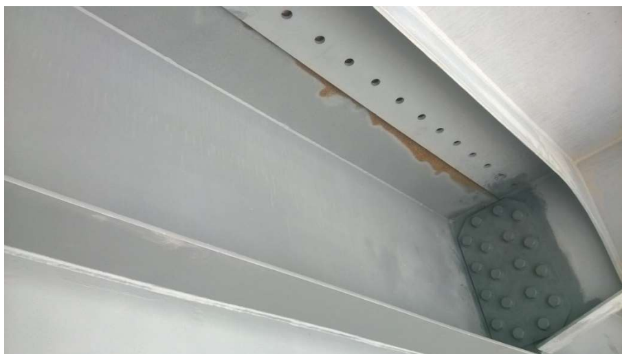
Рисунок 2 – Общий вид на металлические конструкции пролетного строения моста. Отсутствие защитного лакокрасочного покрытия, следовательно, развитие поверхностной коррозии элемента
