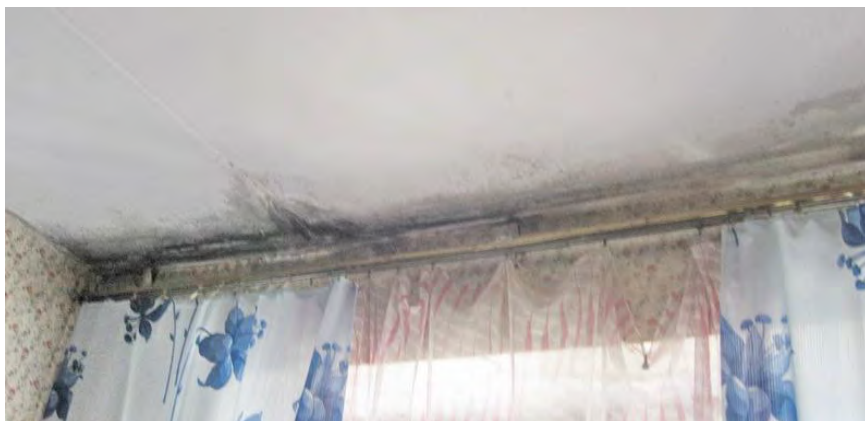
Рис. 1.8. Плесень наружной стены по стыку с перекрытием в жилой комнате
