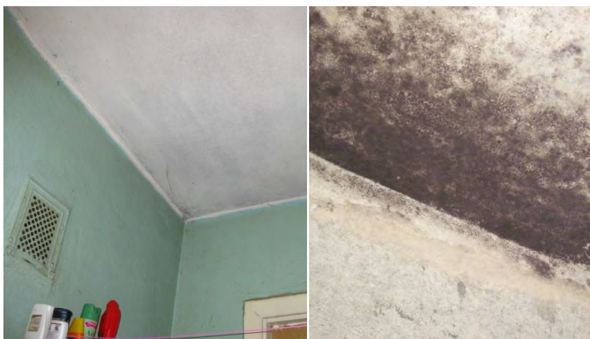
Рис. 1.9. Увлажнение и плесень потолка в ванной комнате и санузле
