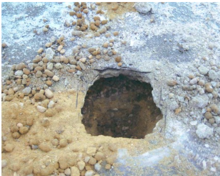
Рис. 7.2 Вскрытие совмещённого покрытия со слоем теплоизоляции из керамзитового гравия толщиной \delta = 140 мм и \rho = 600 кг/м 3
