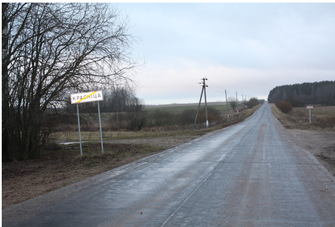
Рисунок 2 – Современное состояние бетонного покрытия
