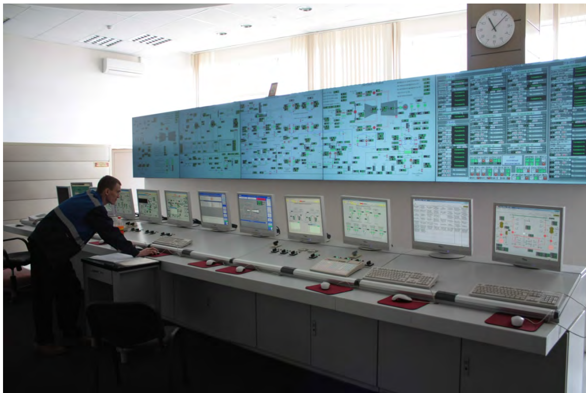
Рисунок 2.49 – Вид блочного щита ПГУ-230
