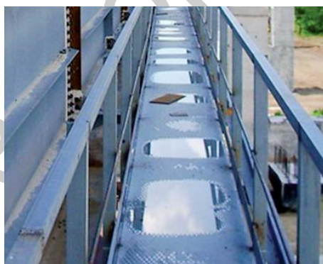
Рисунок 2 - Локальные зоны застоя воды в зоне служебного прохода
