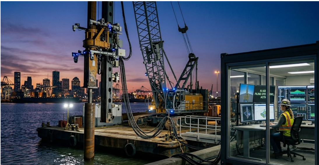
Рисунок 1 – Автоматизированный сваебойный комплекс с интеграцией ИИ-агента при устройстве оснований в прибрежной зоне
