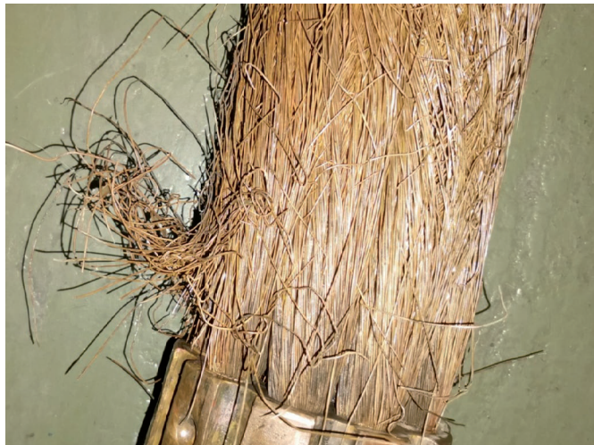
Рис. 10. Износ и разрыв проволок элементарных прядей (стренг) из-за низкой стойкости проволок к перегибам ввиду плохого качества использованной меди и недостаточного ее отжига
