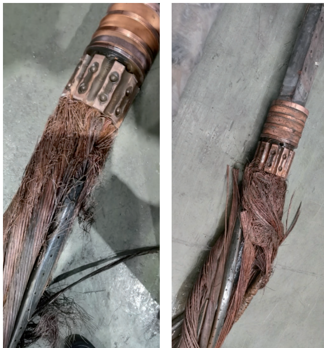
Рис. 4. Повреждение и разрыв внутренних жил кабеля
