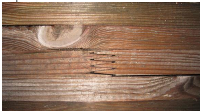
Рис. 1. Дефект зубчатого соединения
