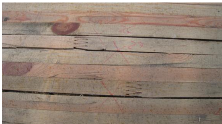
Рис. 2. Трещины по клеевым прослойкам
