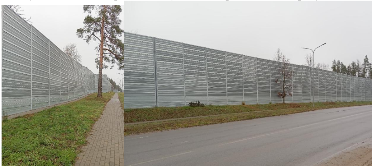
Рис. 3. Общий вид шумозащитного экрана после усиления стальными шляпными профилями.
