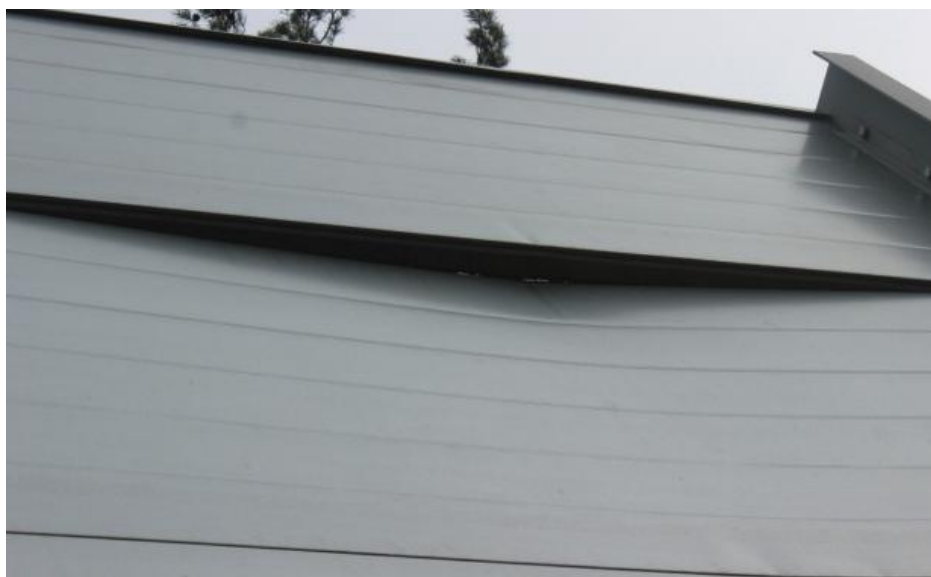
Рис. 2. Деформация шумозащитных панелей более 80 мм
