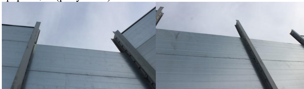
Рис. 1. Отсутствие шумозащитных панелей в результате их обрушения
