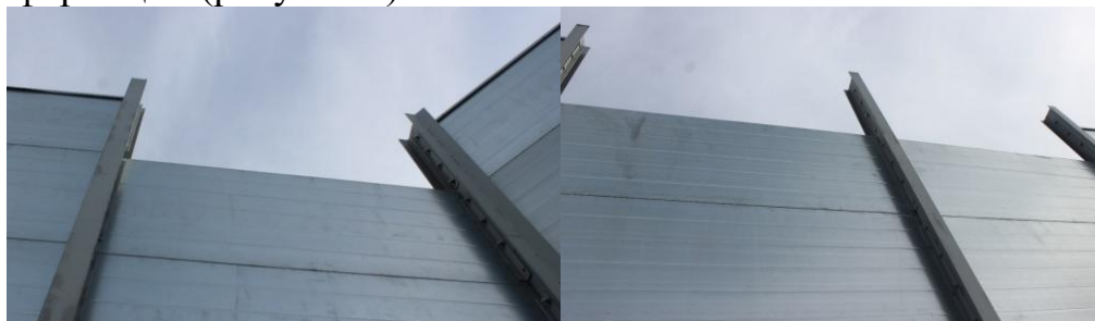
Рис. 1. Отсутствие шумозащитных панелей в результате их обрушения
