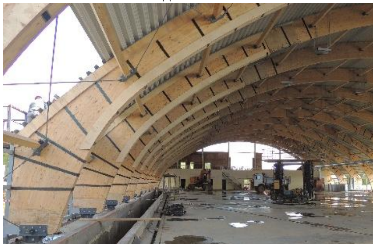
Рис. 8. Фрагмент усиления двухшарнирной арки
