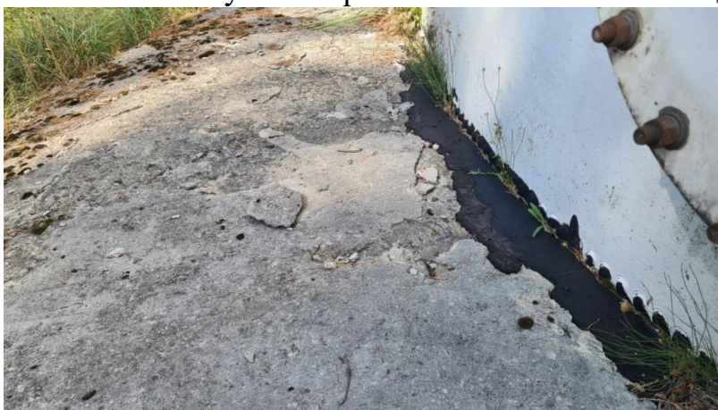
Рис. 3. Текущее состояние отмостки РВК-1000
