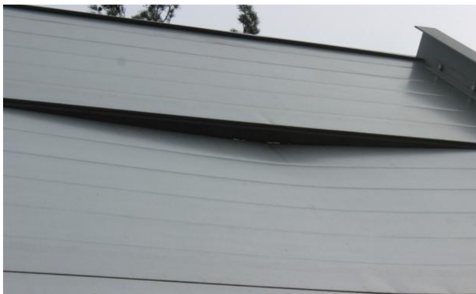
Рис. 2. Деформация шумозащитных панелей более 80 мм
