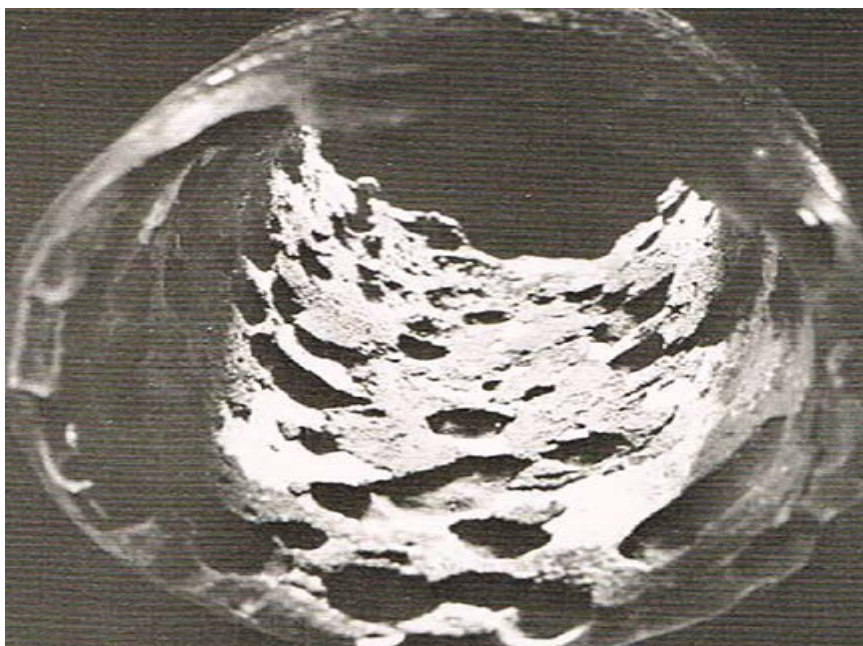
Рисунок 1 – Результат эрозийной коррозии в трубопроводе
