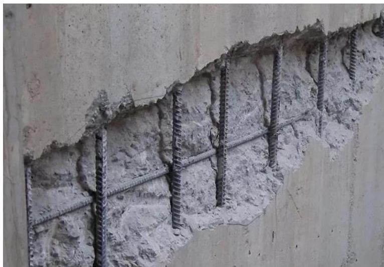
Рисунок 2 – вскрытие защитного слоя бетона
