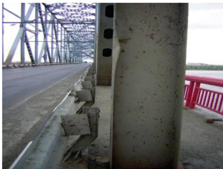
Рисунок 1 – Дефекты и повреждения стальных конструкций
