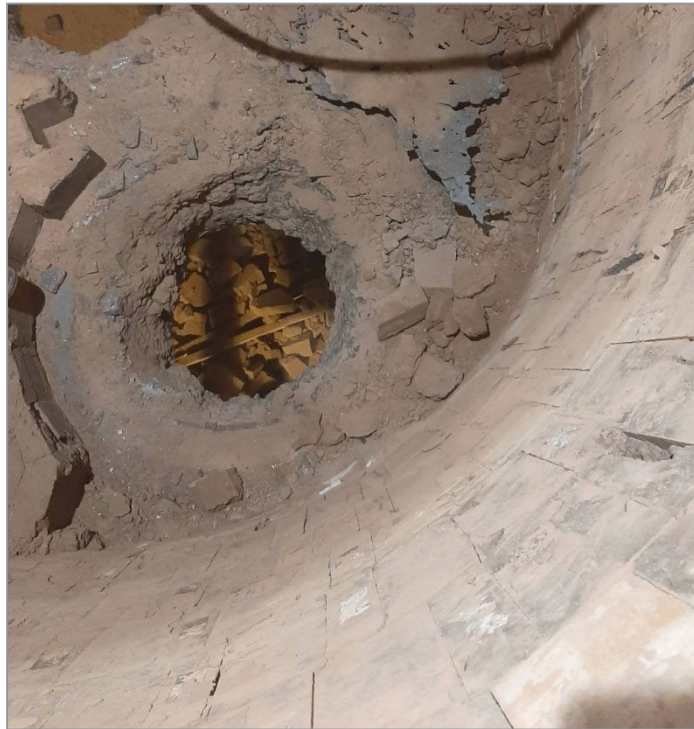
Рис. 1. Образование раскрытий швов стыковочных поверхностей огнеупорных колец нижней камеры вакууматора RH
