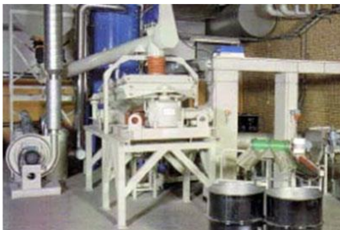
Рисунок 69 – Общий вид установки термической демеркуризации РСО .
