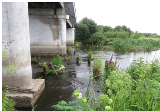
Рис. 4. Остатки деревянных свай в русле р. Свисloch под мостом на 9 км автодороги П00056 Подъезд от а/д Минск – Гомель к д. Пуховичи
