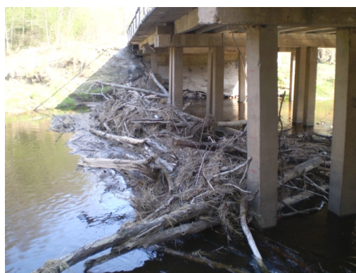
Рис. 5. Нагромождение плавника в русле р. Черница под мостом на автодороге Н-2906 Костеево – Бабиновичи, км 10,165
