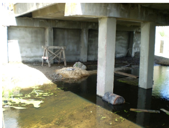
Рис. 1. Строительный мусор в русле р. Ведрич под мостом на автодороге Н-4162 Речица – Горваль – Василевичи, км 70,061
