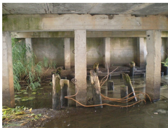
Рис. 2. Остатки деревянных свай, арматура в русле канала под мостом на автодороге Н-3900 Буки – Мосар, км 7,32
