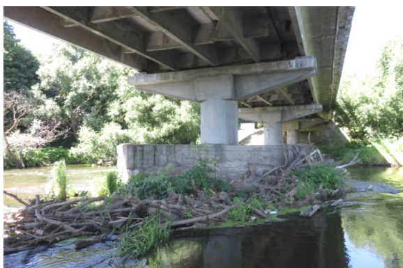
Рис. 3. Нагромождение плавника в русле р. Свисloch под мостом на 9 км автодороги Н-9350 Голоцк – Зазерье – Седча – Озеричино
