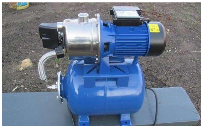
Рисунок 1. – Датчик давления в автономном водопроводе
