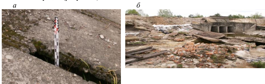
а – разрушение крепления откоса плотины; б – авария водосброса
