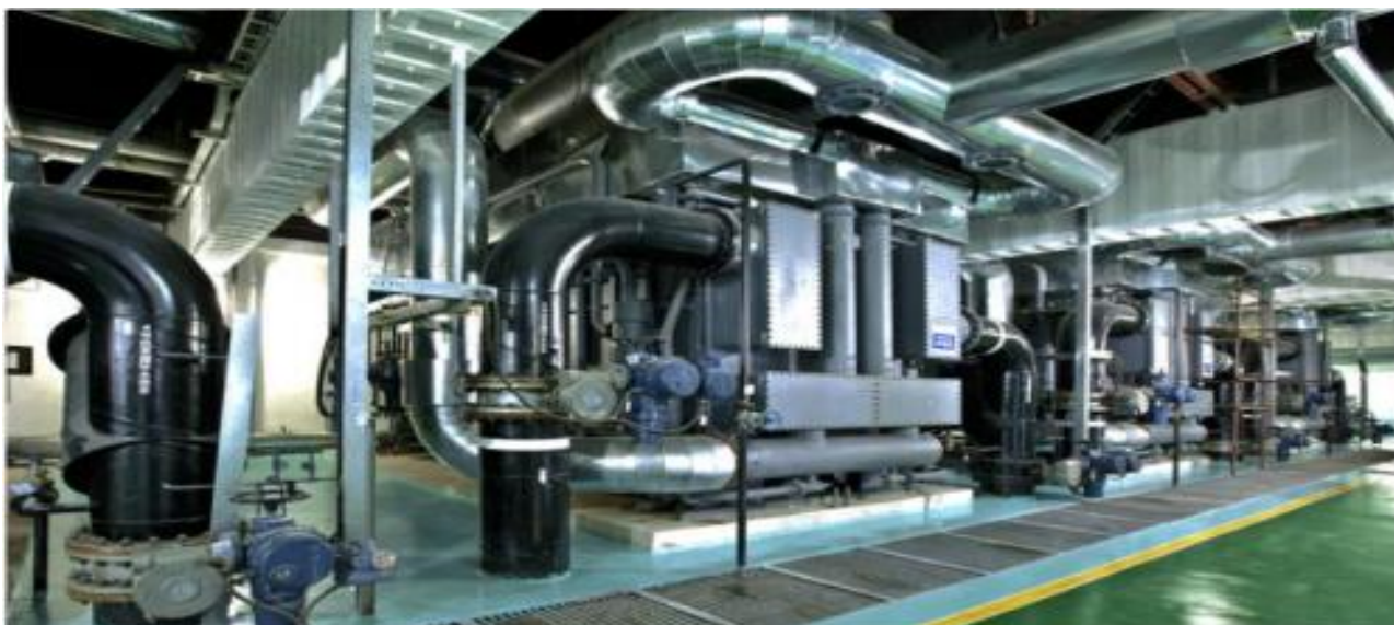
Рисунок 1 – Общий вид чиллера АБТН в составе теплонасосной установки
