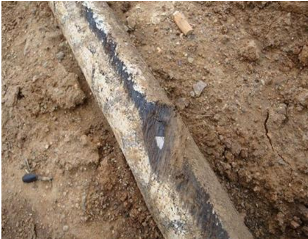
Рисунок 1 – Отсутствие возможности своевременно определить места повреждений кабелей из-за высокого электрического сопротивления стенки трубы
