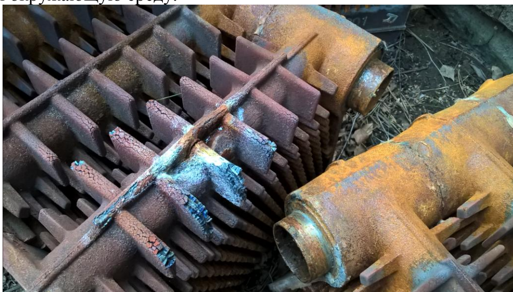
Рисунок 2 – Коррозия и разрушение поверхностей нагрева парового котла [1]
