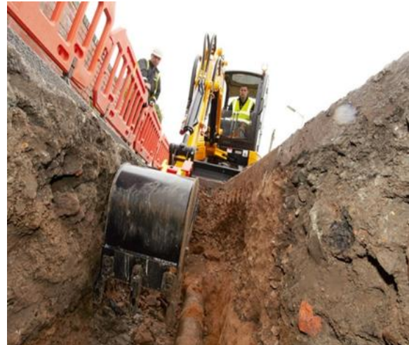
Рисунок 2 – Повреждение КЛ из-за воздействия сторонних лиц ввиду отсутствия достоверных данных о расположении трубного кабельного канала, проложенного методом горизонтальное направленное бурение (ГНБ)
