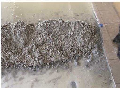
Рис. 8. Прорыв дамбы с выносом грунта
