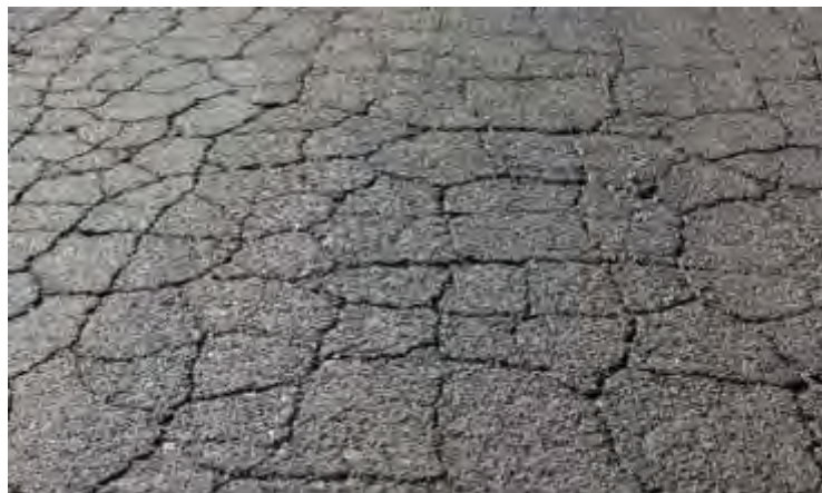
Рис.15.5 Разрушение битума в процессе старения
